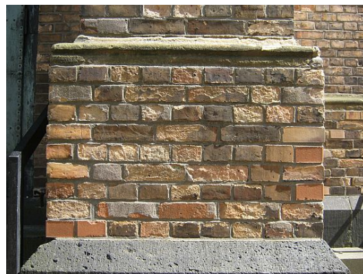
Schalenbildung an einem vor etwa 40 Jahren hydrophobierten Klinkermauerwerk.
