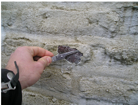
Anstriche und Beschichtungen haften nur sehr eingeschränkt an hydrophobierten Untergründen, hier einem Ziegelmauerwerk.
