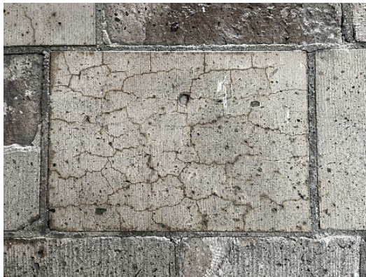
Hydrophobierter, oberflächlich trockener Tuffsteinquader mit durchnässtem Kern. Die Feuchtigkeit tritt entlang der Rissbildungen an die Oberfläche. Foto: Christoph Schaab/LVR-ADR
