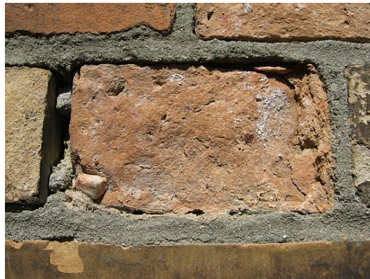
Salzanreicherung hinter einer inzwischen abgefallenen Schale an hydrophobiertem Klinkermauerwerk. Foto: Christoph Schaab/LVR-ADR
