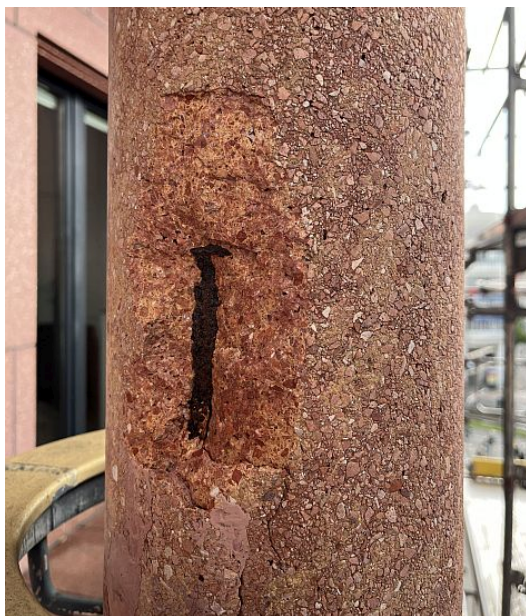
Korrodierte Bewehrung und Abplatzungen an einer feingliedrigen Stütze aus farbigem Edelbeton der 1950er Jahre.
