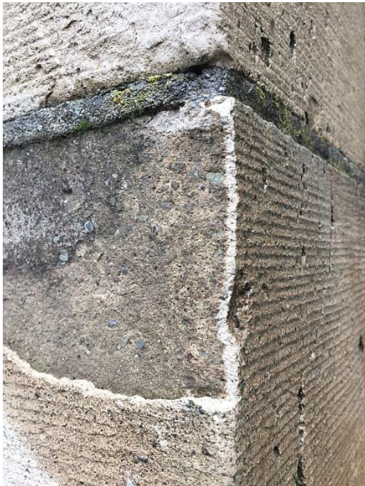
Hydrophobierter Tuffsteinquader nach etwa 40 Jahren. Oberfläche und Kern sind benetzbar, die von der Hydrophobierung erfasste oberflächennahe Zone bleibt dauerhaft wasserabweisend. Foto: Christoph Schaab/LVR-ADR
