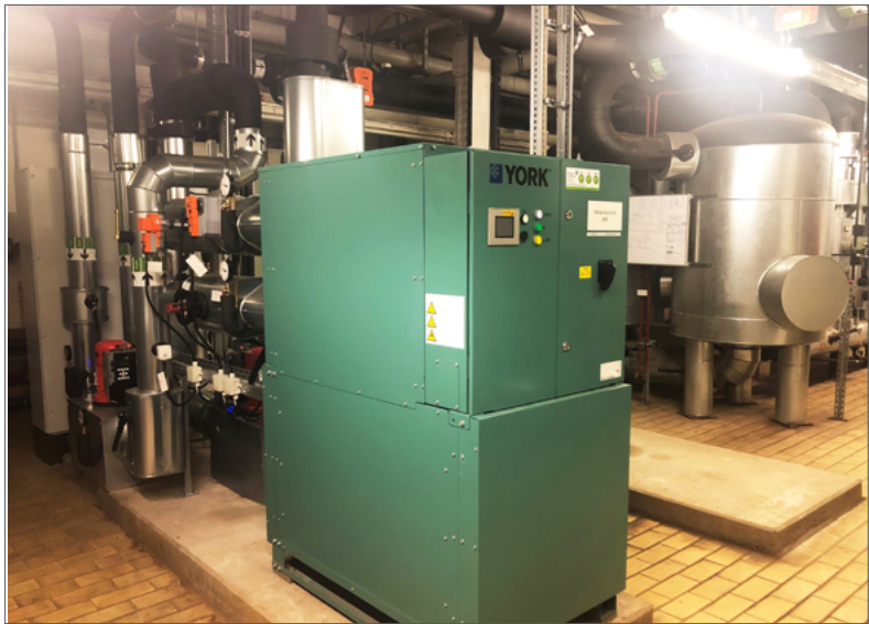
Bild 13 – Neue Kältemaschine im Landeshaus
