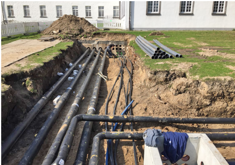
Bild 15 – LVR-Kulturzentrum Brauweiler, Leitungsführung der Energieversorgung
