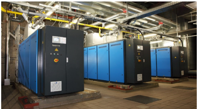
Bild 24 – LVR-Klinikum Düsseldorf, Neue Blockheizkraftwerke
