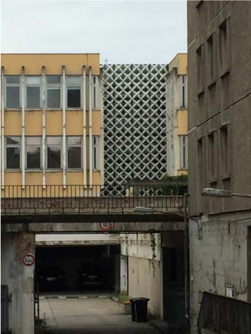
Die heruntergekommene Fassade der Fachhochschule, Foto: M. Karabaic , Herbst 2017
